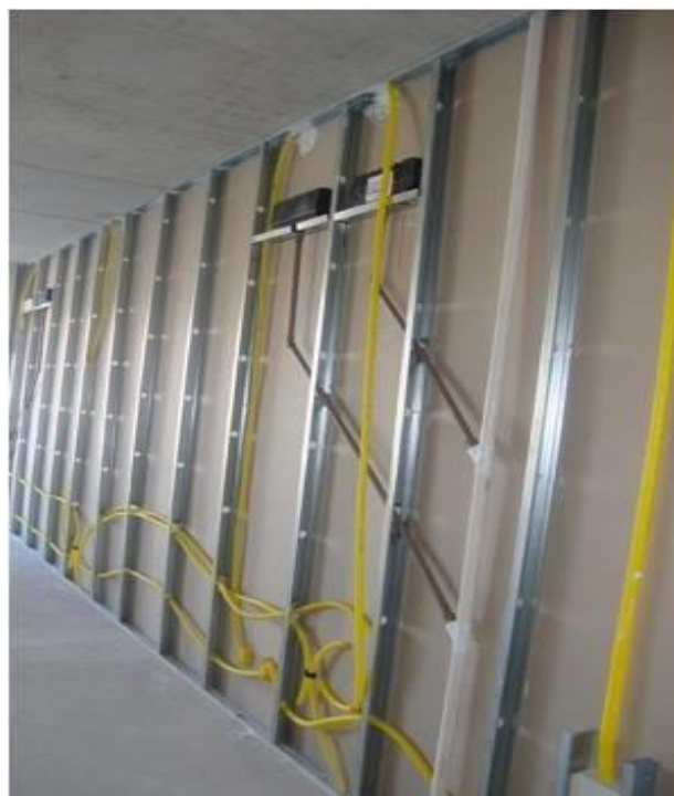
Foto 04: Exemplo do que pode existir dentro de uma simples parede de dry-waal (gesso acartonado), várias instalações elétricas, de TV, drenos para ar condicionado etc.
