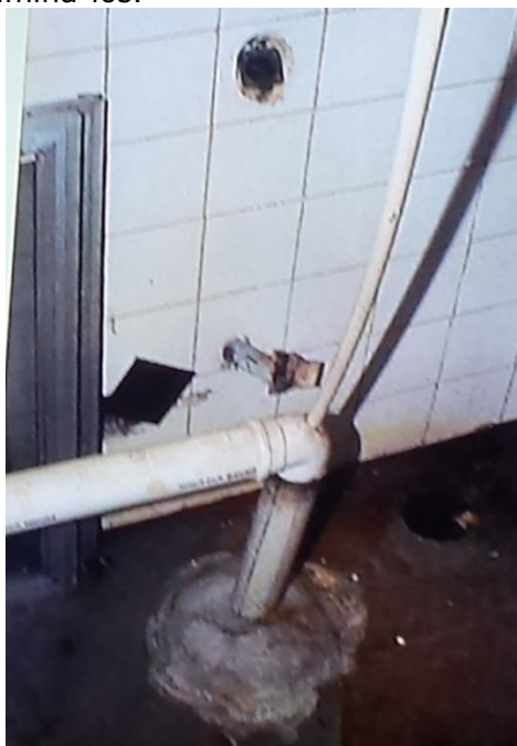
Foto 05: Alteração de instalação de esgoto sem nenhum critério técnico
